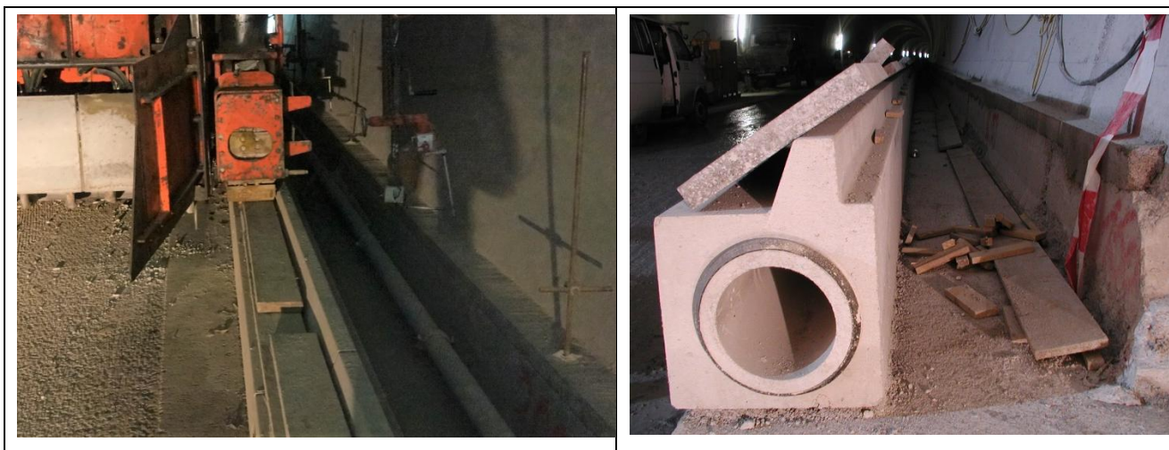
Obr. 23 Kabelové žlaby v tunelech Götschka (vlevo) a Strengen (vpravo)
